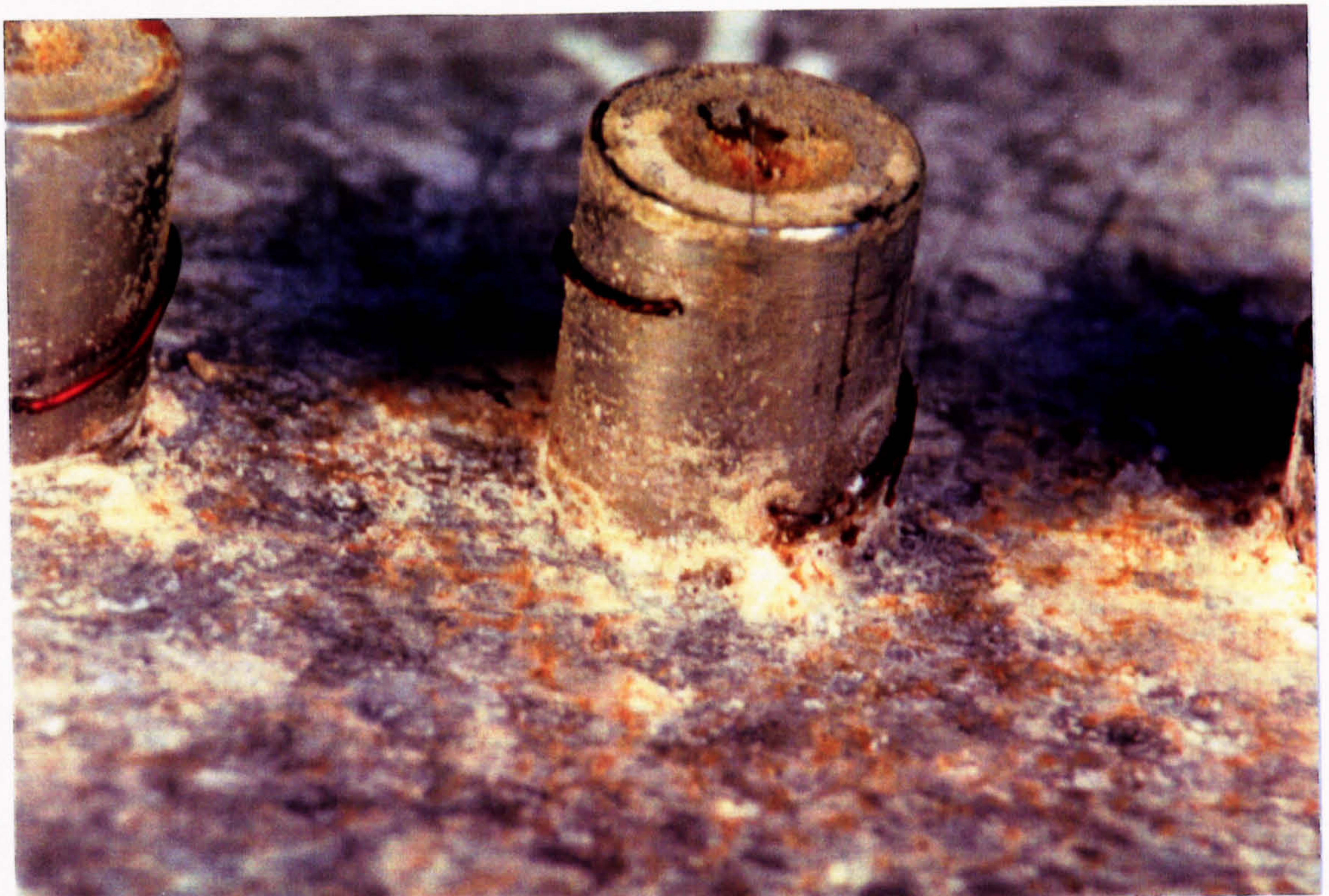
Photograph (d) : Salt Deposits found on Gas Injector Nozzles
